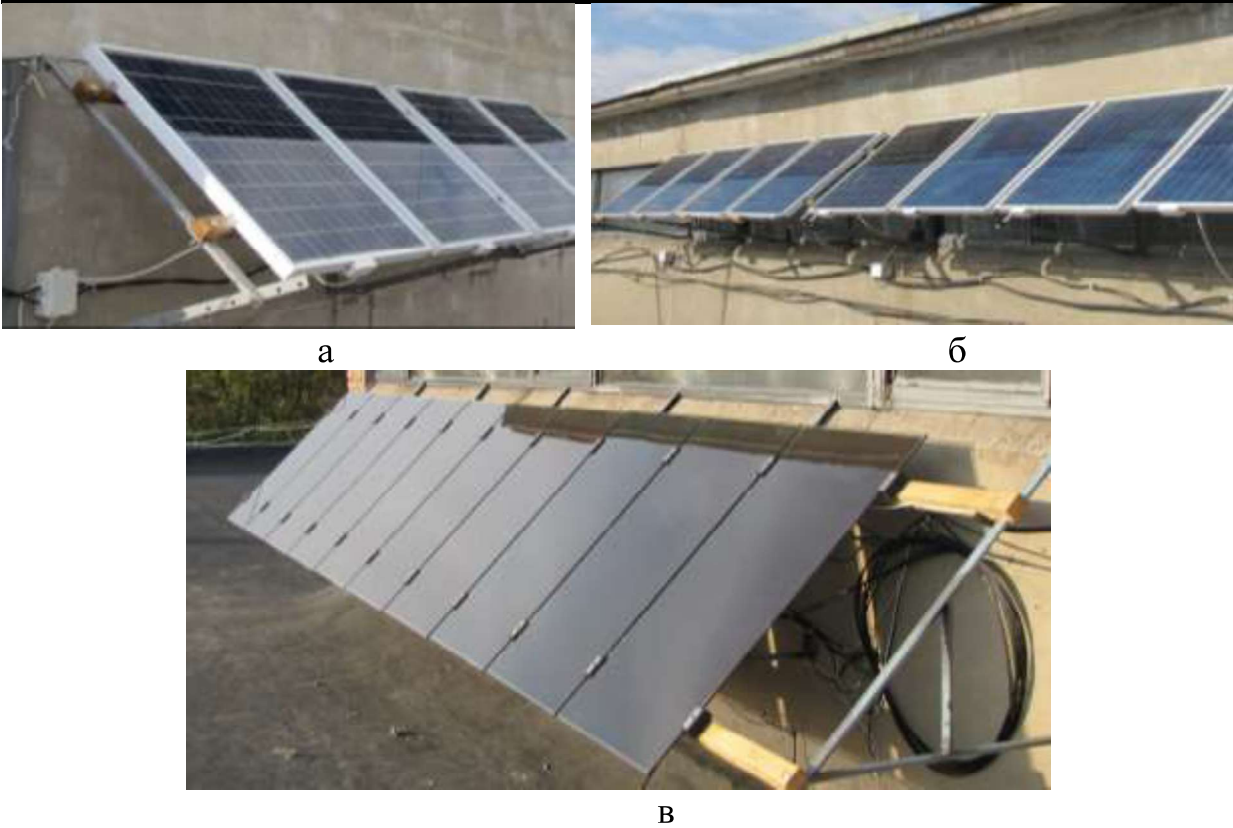
Рисунок 1 – Загальний вигляд сонячних панелей
